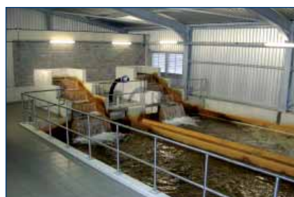
Binnen in het filtergebouw
