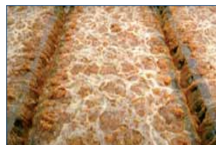
Spoelen van een zandfilter
