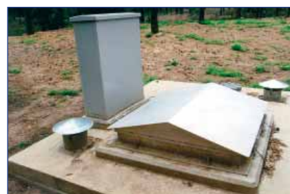
Watervangput - bovengronds gedeelte
