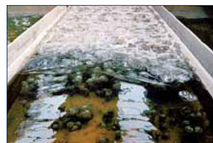
Spoelen van zandfilter - beginfase
