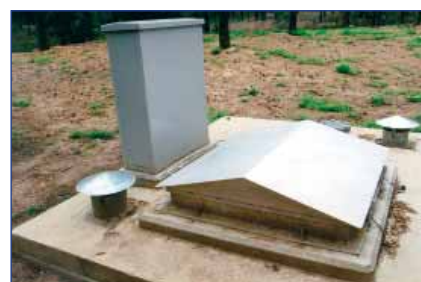
Watervangput - bovengronds gedeelte
