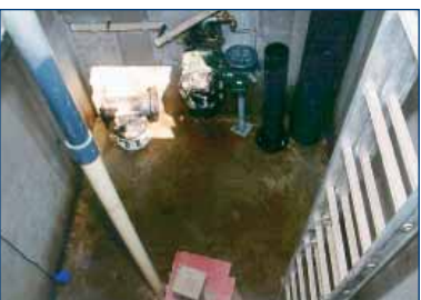
Waternvangput - ondergronds gedeelte
