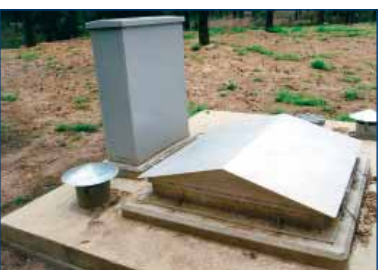
Waternvangput - bovengronds gedeelte
