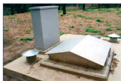
Watervangput - bovengronds gedeelte
