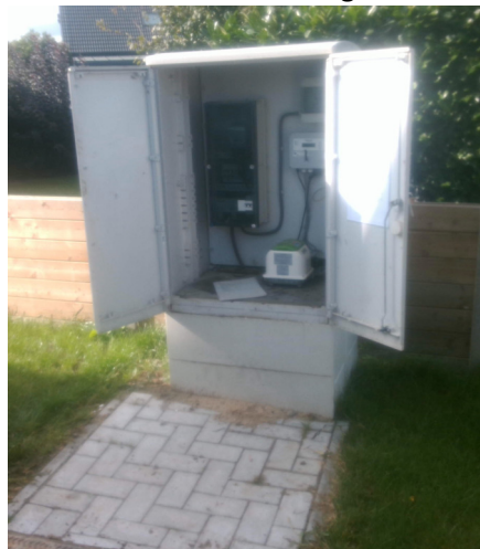
Voorbeeld van een sturingskast:
