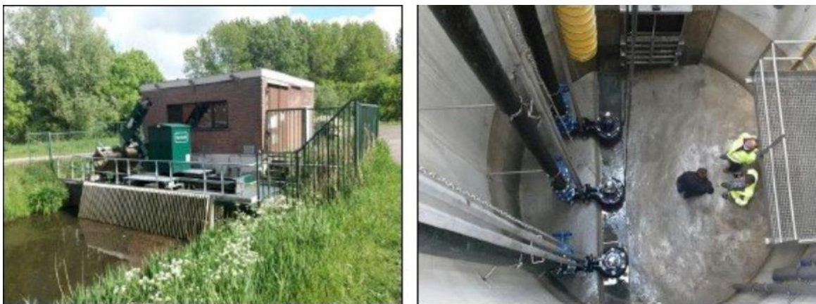
Figuur 37: Pompemaal in polder van Sinaai-Daknam. Bron: VVWP.
