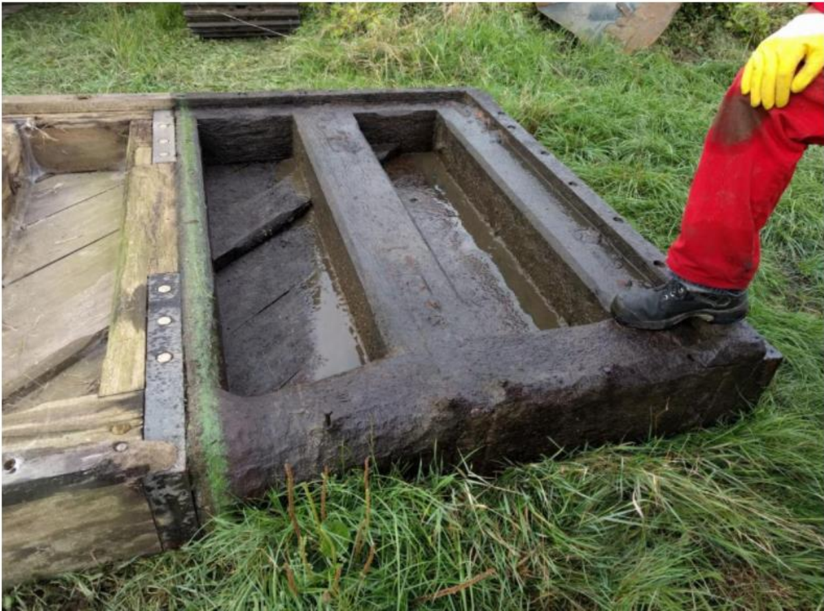
Gedemonteerde houten sluisdeur die door bevers is aangeknaagd (vergelijk rand voorgrond met rand achtergrond) waardoor functionaliteit afnam ©Waterschap Aa en Maas Het ANB meldt ook voorbeelden van kunststofschotten die kapot geknaagd werden in provincie Antwerpen.
