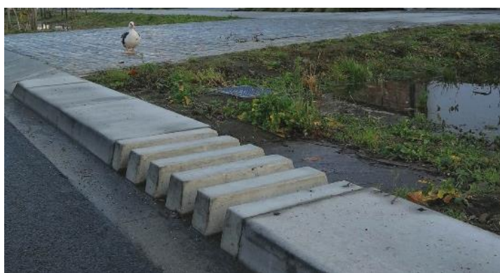
Figuur 33. Een voorbeeld van een boordsteen met spleten zoals toegepast in de Fortstraat in Morsel (Bron: dbpubliekeruimte.info).
